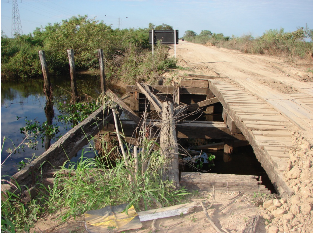
Figura 1.15: Ponte quebrada no KM 23 da Estrada Parque Pantanal (2012).
