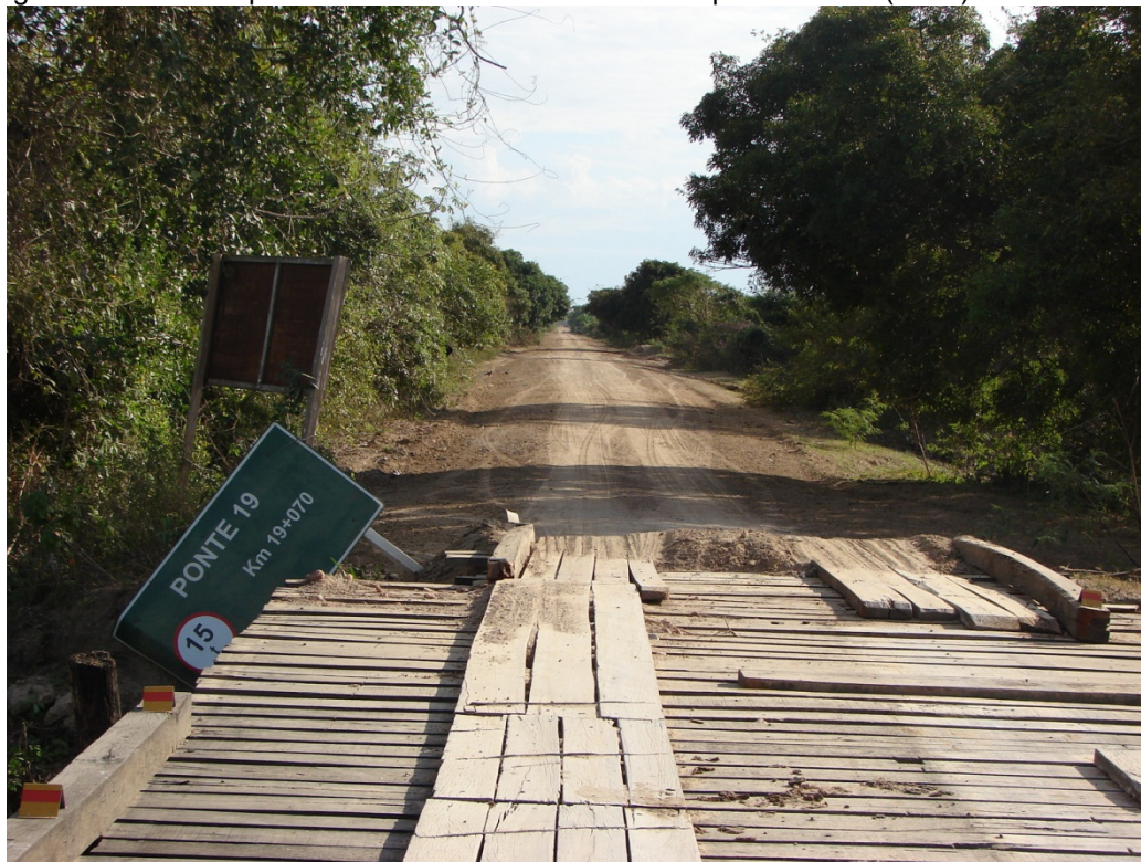
Figura 1.16: Ponte quebrada no KM 19 da Estrada Parque Pantanal (2012).
