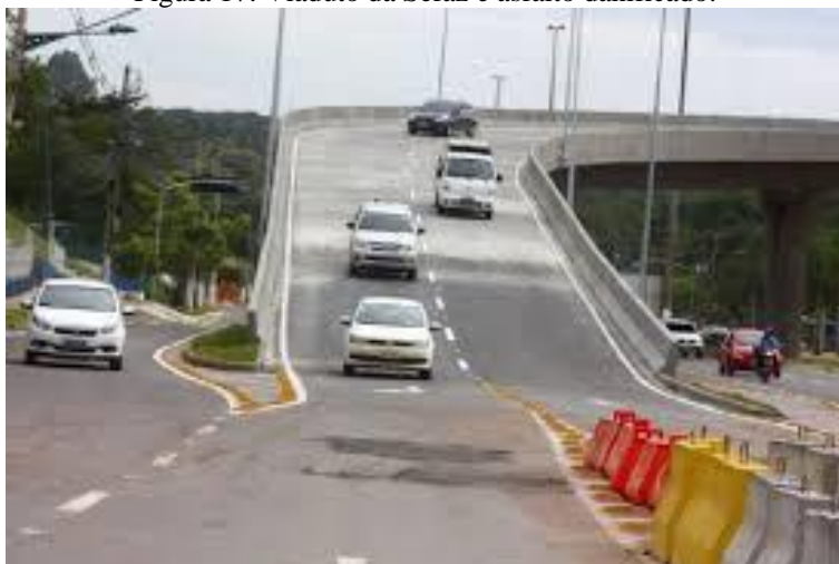
Figura 17: Viaduto da Sefaz e asfalto danificado.
